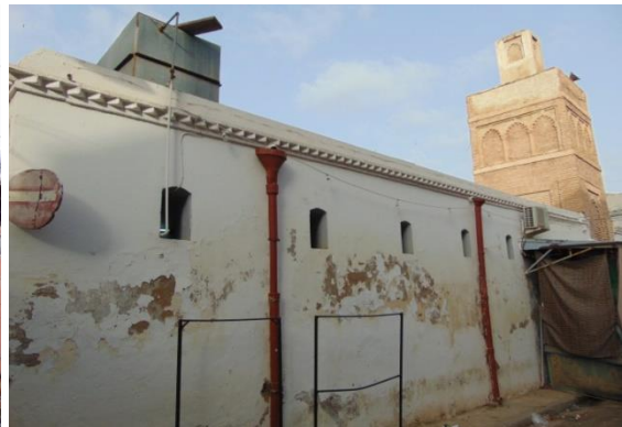
Figure 2: Restauration de mosquée Sidi El Benna du 14ème siècle à Tlemcen, Algérie. Nous pouvons voir que l'approche non scientifique a défiguré le monument par le blanchissement du minaret, les climatiseurs et réservoirs installés sur le toit, les systèmes modernes d'évacuation des eaux et les constructions parasites ajoutées au monument. Photo prise par Alexandru-Ionuț Petrișor
